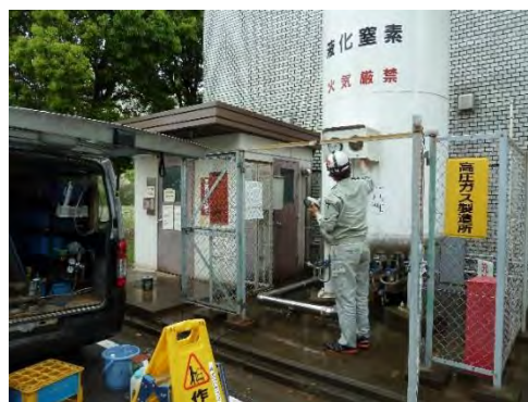
Cold Evaporator 定期メンテナンス
