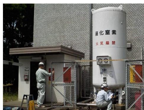
Cold Evaporator 定期メンテナンス
