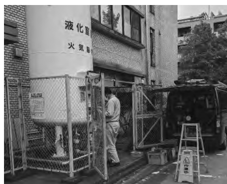
定期メンテナンス Cold Evaporator
